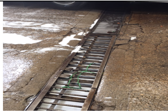
Foto No. 2. Rejillas utilizadas para retención de aguas residuales no domésticas
