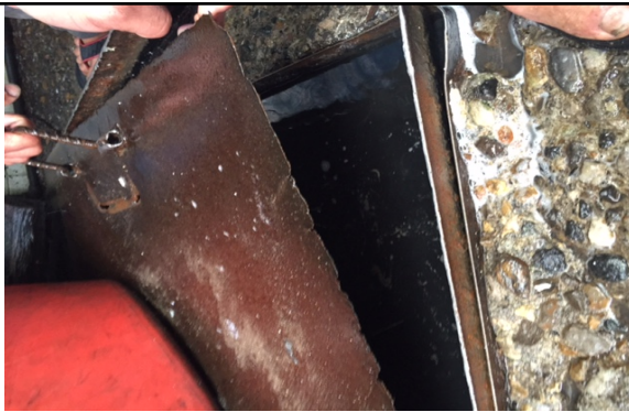
Foto No. 1. Desarenador utilizado para el tratamiento de aguas residuales no domésticas.
